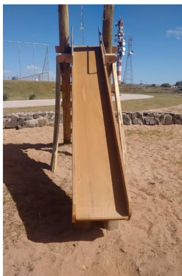
Figura 10 - Praça Iris Yolanda Vieira Cornejo – escorregador sem não tem o assento de apoio para a criança sentar antes da descida e há risco de queda devido à inclinação do brinquedo.
