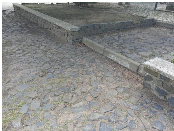
Figura 4 - Praça do Desembarque – calçadas de passeio desniveladas.
