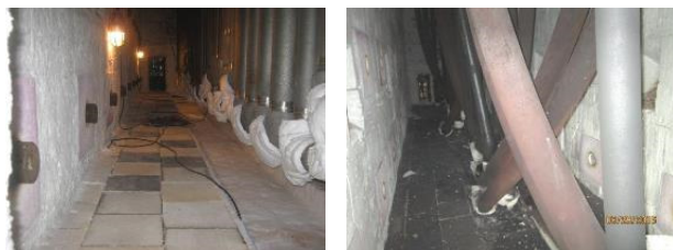
Figura 2 e 3. Aspecto geral de um forno de pirólise com serpentinas que possuem tubos onde foi utilizado a liga 30Cr-45Ni-5Al. 2) Condição no início de operação. 3) Condição após 33.000 h de serviços apresentando severo alongamento por fluência.
