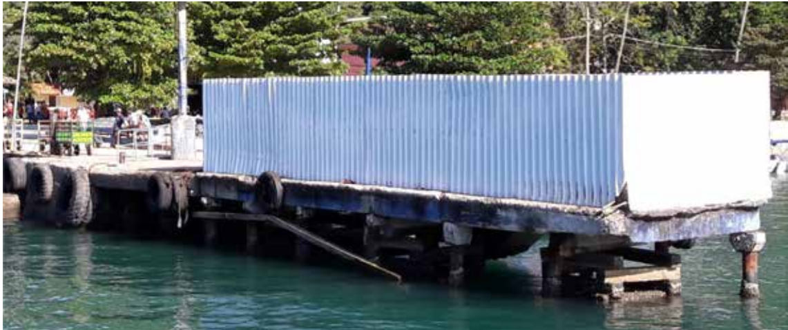
Figura 2 – Cais do Abraão – detalhe da estrutura do cais em colapso, escorada por estacas de madeira enquanto carreteiros aguardam a próxima carga ancorar
